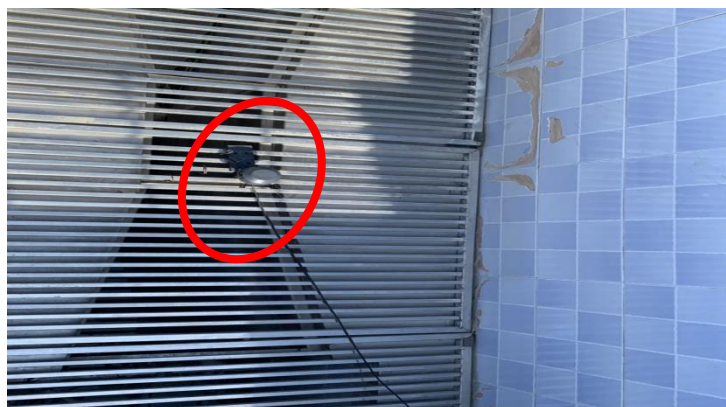
图8 排水口PH计探头安装位置
